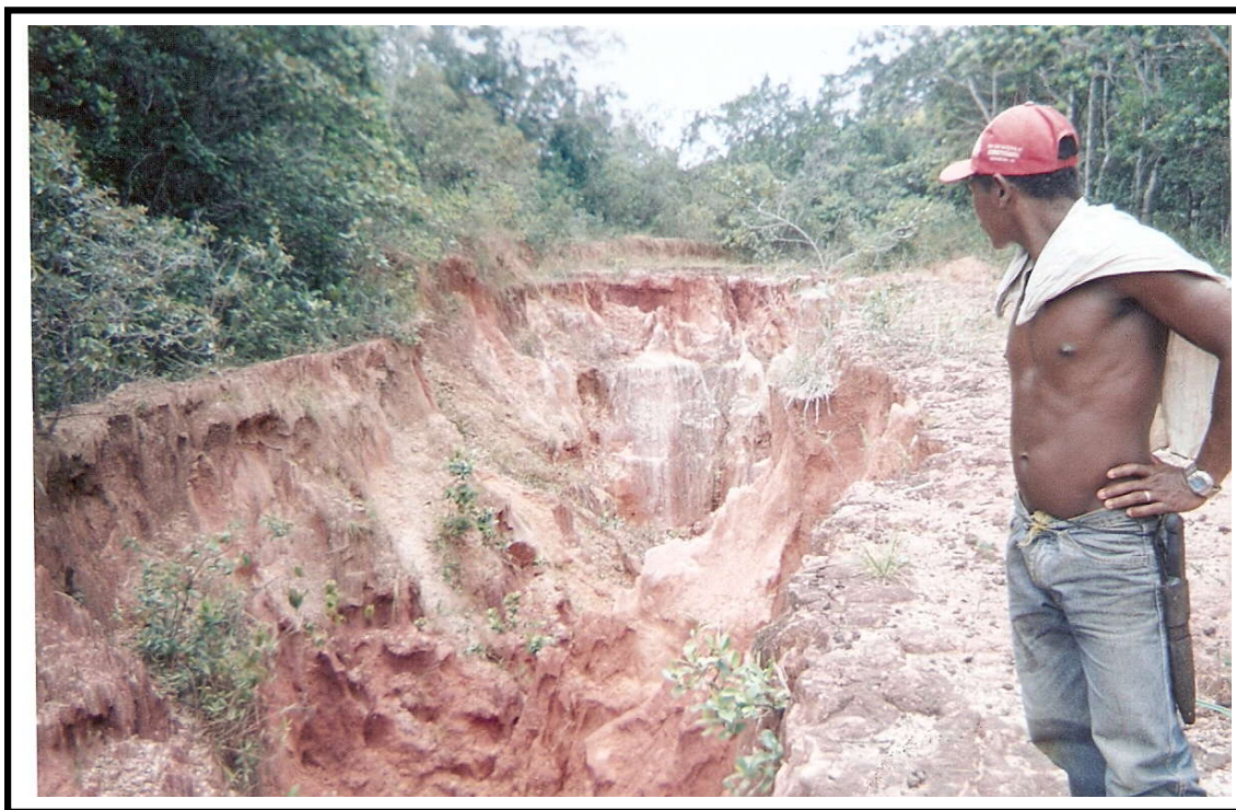
Foto 36 – Voçoroca em Estrada aberta na Mata
